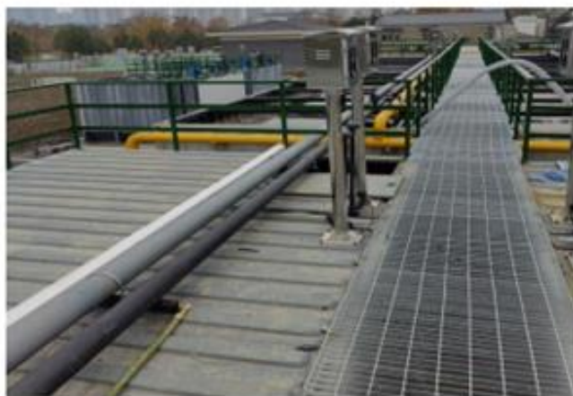
Dự án xử lý nước thải tại nhà máy thực phẩm ( 某食品厂污水处理项目)
